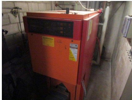
6.22 Heizkessel 42 kW (Brenner 2005 ersetzt)
