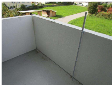
6.10 Balkonbrüstung mit 82cm zu niedrig
