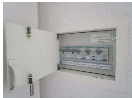
6.21 Unterverteilung Wohnungen (neueren Datums)
