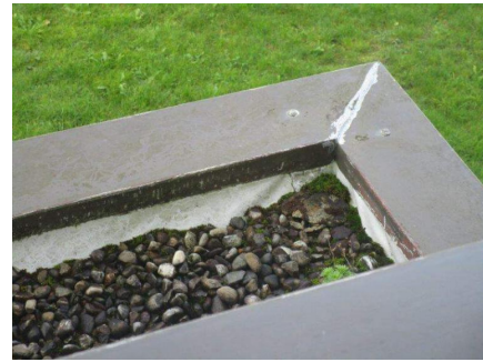
6.2 Vordach Haupteingang Kunststoffabdichtung mit Zugspannungen
