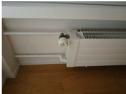
6.23 Heizkörper mit Thermostatventilen
