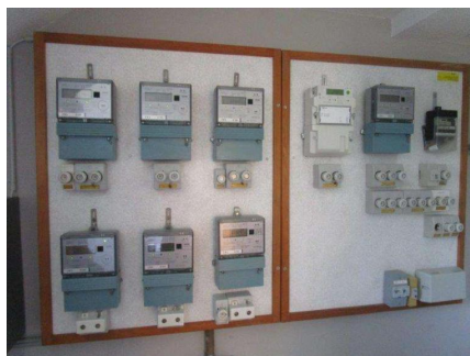
6.20 Hauptverteilung mit asbesthaltigem Tableau (Zähler 1998 ersetzt)
