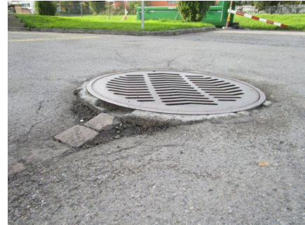
6.33 Asphaltbelag mit Rissen + örtlichen Setzungen
