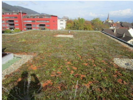
6.3 Hauptdach Wohnhaus ohne Absturzsicherung
