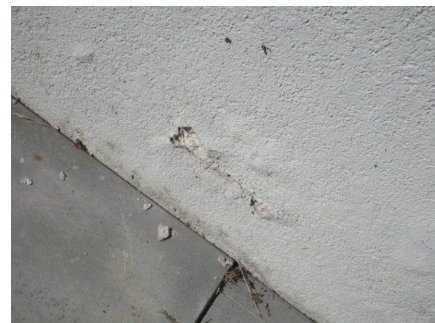
6.7 Teilweise örtliche Putzbeschädigungen Sockelbereich Wohnhaus
