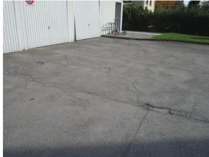
6.32 Asphaltbelag mit Rissen und teilweise Abplatzungen
