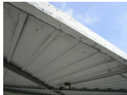
6.18 Metallkipptor Garagenbau leichte Farbablösungen
